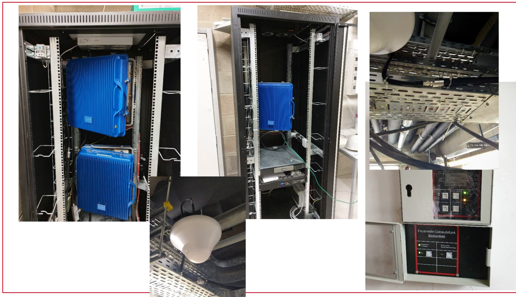
Couverture radio intérieure dédiée aux services de secours et de sécurité
