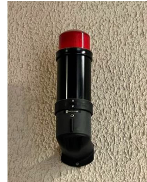
Bei Gasaustritt: Voralarm: blinkendes Warnlicht (Flash) Hauptalarm: akustischer Alarm (Sirene)
